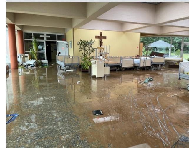
In der Eingangshalle am Marien-Hospital Erftstadt-Frauenthal zeigte sich das Ausmaß der Zerstörung durch die Wassermassen
