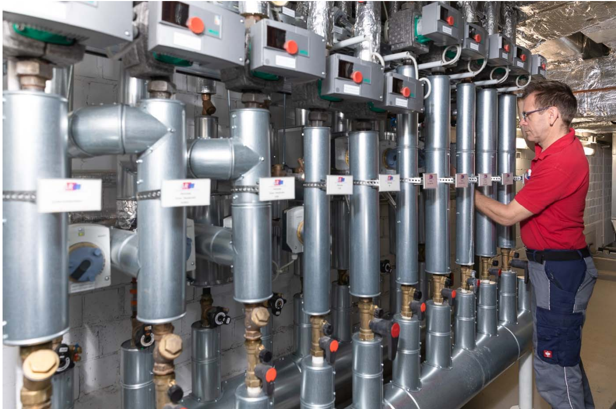
Symbolbild (© DRK-Kinderklinik Siegen gGmbH): Heizungsanlage im Krankenhaus – Energiepreisentwicklung belastet Siegener Kliniken
